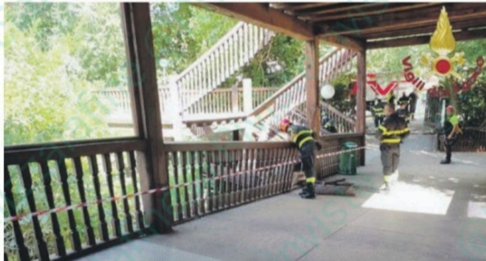
Due immagini del crollo della scala di legno nell'arena di Villa Borghese a Roma
